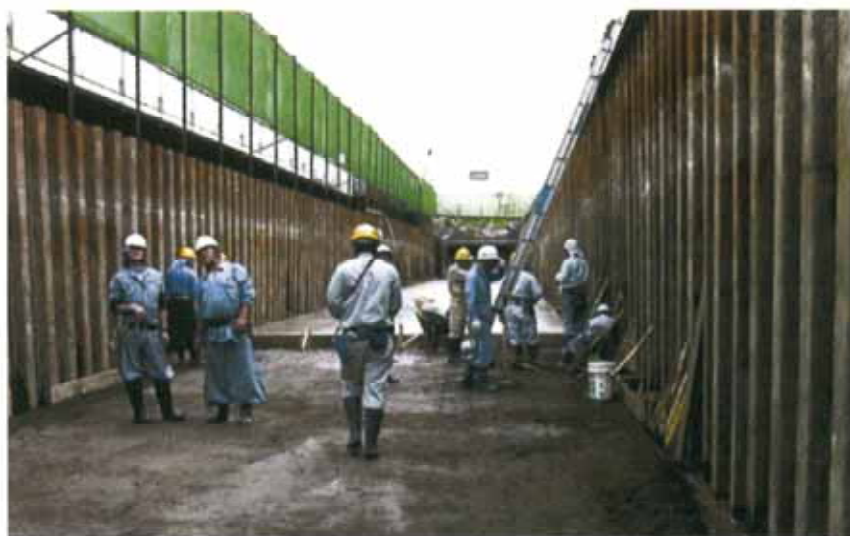
↑パーマロック・ASF-IIを用いたエキスパッカ工法によるボックスカルバート基礎の液状化対策工における注入後の掘削底盤の状況
